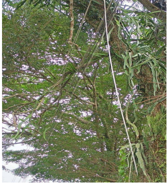
Figura 60 - Evidência de Campo Canoas – Município Gravataí - Fonte: RGE
