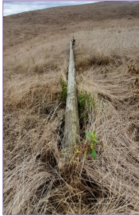
Figura 68 - Evidência de Campo Planalto, Município São Jorge - Fonte: RGE
