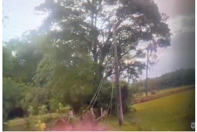
Figura 64 - Evidência de Campo Canoas – Município Gravataí - Fonte: RGE
