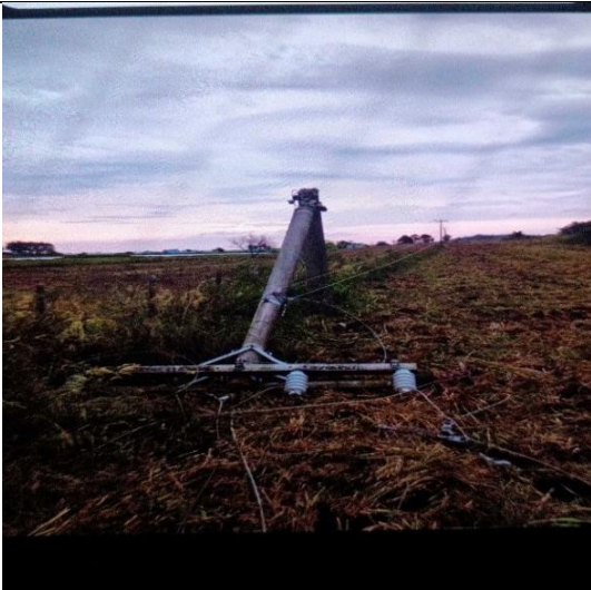
Figura 77 - Evidência de Campo Pampas, Município Rosário do Sul - Fonte: RGE
