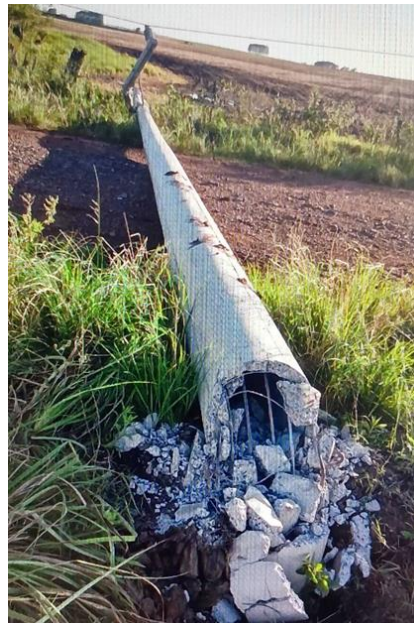
Figura 34 - Evidência de Campo da Central, Região de Caçapava do Sul - Fonte: RGE
