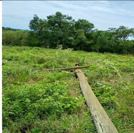
Figura 88 - Evidência de Campo Central, Município Dilermando de Aguiar - Fonte: RGE
