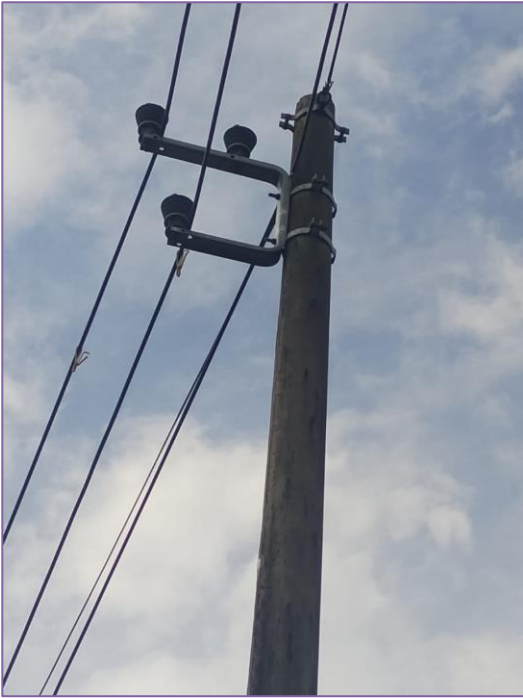
Figura 67 - Evidência de Campo Planalto, Município Nova Prata - Fonte: RGE
