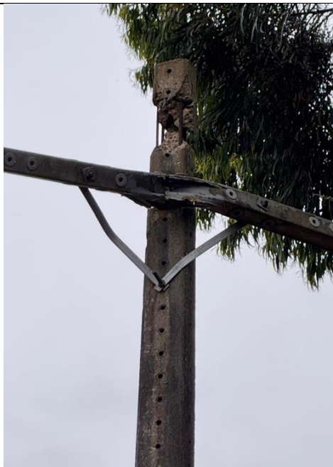
Figura 47 - Evidência de Campo de Planalto, Região de Lagoa Vermelha - Fonte: RGE
