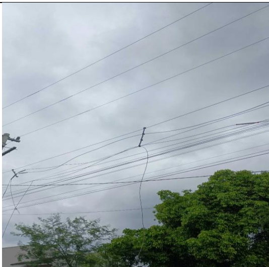
Figura 97 - Evidência de Campo Vale dos Sinos, Município Sapiranga Fonte: RGE
