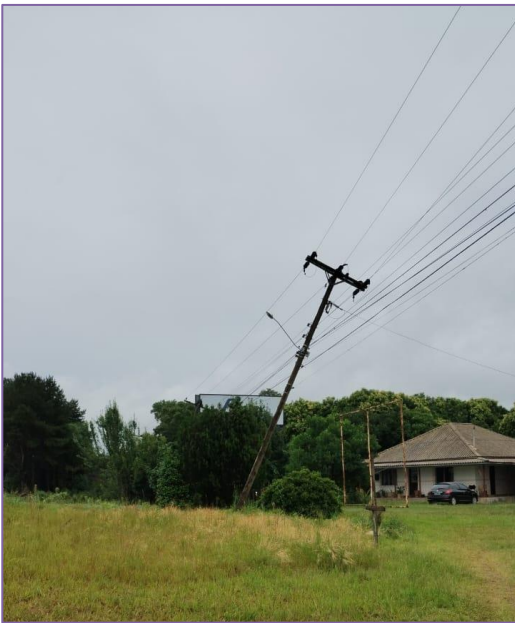
Figura 69 - Evidência de Campo Planalto, Município São Jorge - Fonte: RGE
