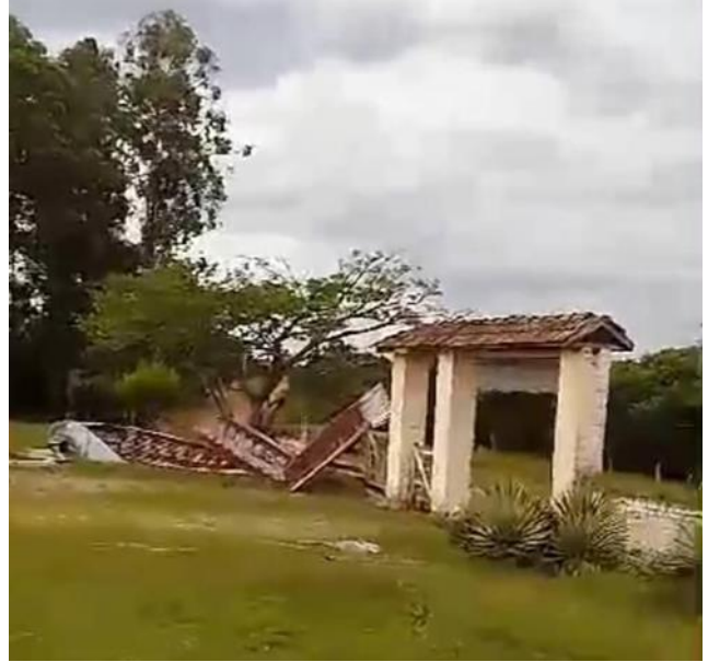
Figura 28 - Evidência de Campo da Central, São Sepé- Fonte: RGE
