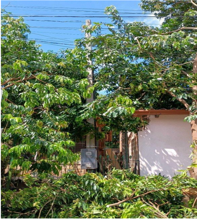
Figura 59 - Evidência de Campo Canoas – Município Gravataí - Fonte: RGE
