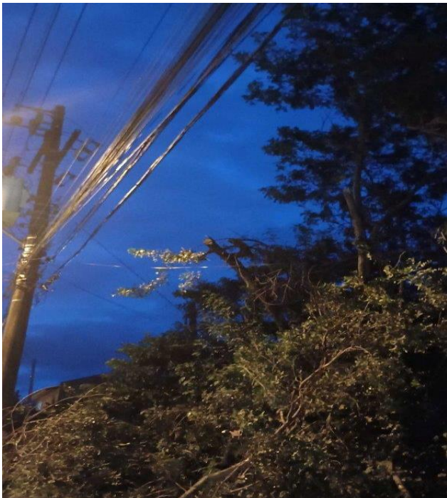
Figura 61 - Evidência de Campo Canoas – Município Gravataí - Fonte: RGE
