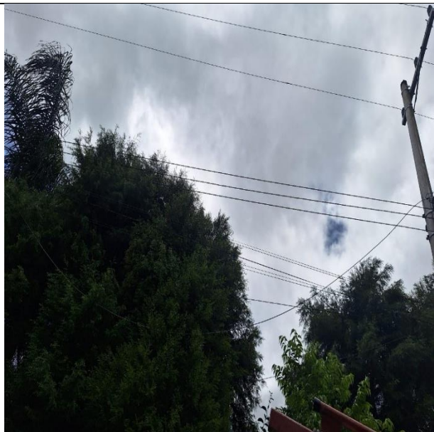
Figura 34- Evidência de Campo Canoas, Município de Gravataí - Fonte: RGE
