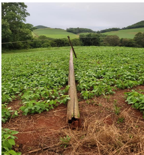
Figura 21- Evidência de Campo Planalto, Município de São José do Ouro - Fonte: RGE
