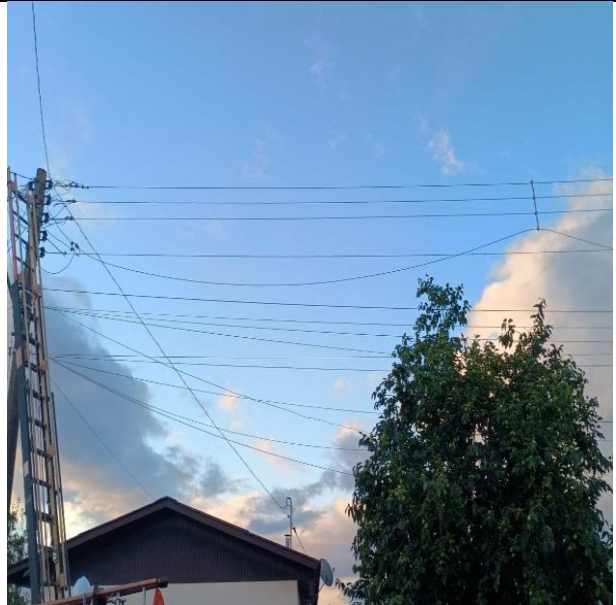
Figura 49- Evidência de Campo Central, Município de Quinze de Novembro - Fonte: RGE
