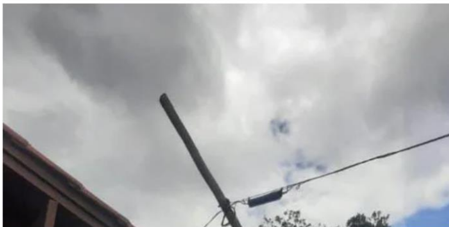
Defesa Civil de Taquara registrou estragos na rede elétrica e queda de um poste | Foto: Alessandro Santos / Defesa Civil de Taquara / CP
